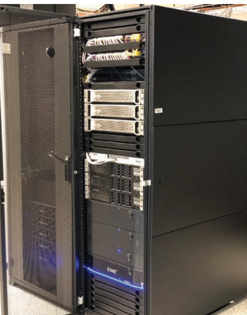
„Data Center” Politechniki Krakowskiej, mieszczące się w serwerowni Akademickiego Centrum Komputerowego „Cyfronet” AGH. Fot.: Zbigniew Marszałik
