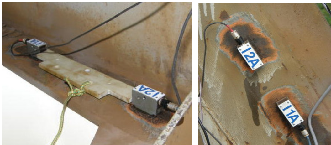
Rys. 4. Głowice ultradźwiękowe na konstrukcji mostu: a – na dolnej półce podłużnicy (miejsce pomiarowe B2), b – na wykrzyżowaniu (miejsce pomiarowe C1)
